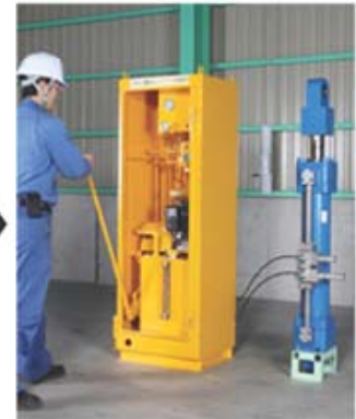
③ゲートの開閉操作を行う。
