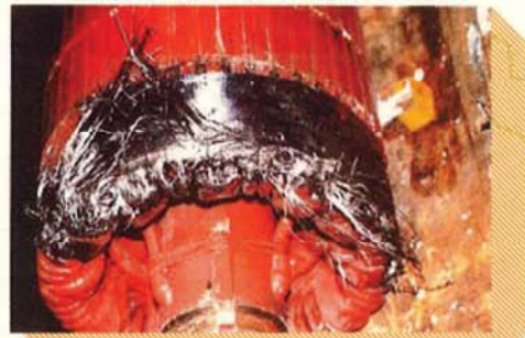
仁尾揚水機場【電動機の損傷】
