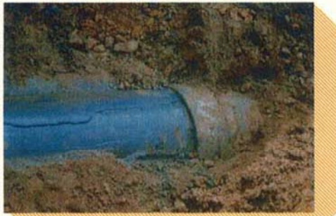
和田支線【石綿管のひび割れ】
