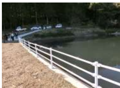
転落防止のために ため池に設置されたフェンス
