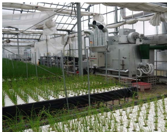
ハウス内に設置されたチップボイラー
