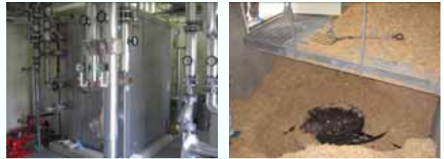
木質バイオマス冷暖房システム(岡山県真庭市) (間伐材等のチップのエネルギー利用による庁舎の冷暖房システム)
