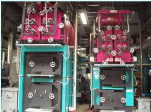
木質バイオマスボイラ(徳島県上勝町) (間伐材等を利用する木質チップボイラ)
