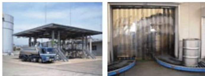
製品貯槽・出荷工程
