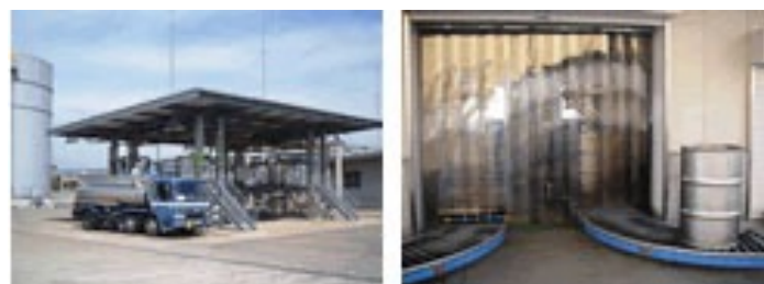
製品貯槽・出荷工程
