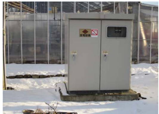
高圧受電設備（キュービクル）
