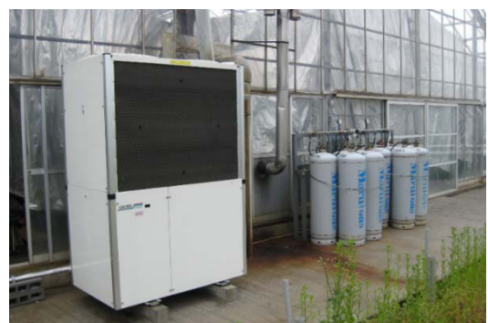
ガスヒートポンプ（室外機）
