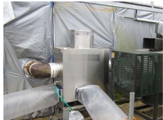
排熱回収装置
