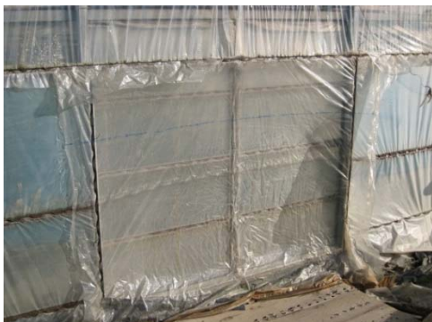
使用しない出入口を目張り
