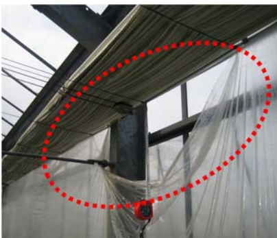
肩部の垂れ下がりによる隙間
