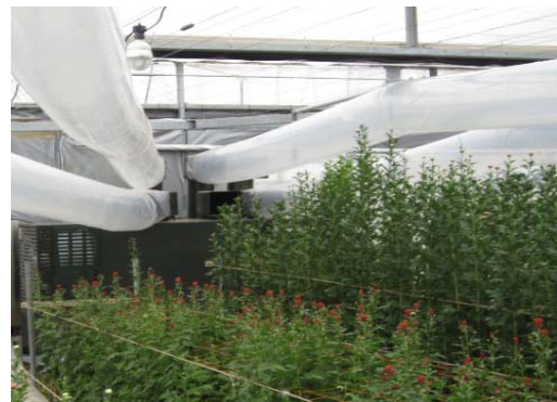
上吹き出しのダクトの設置例
