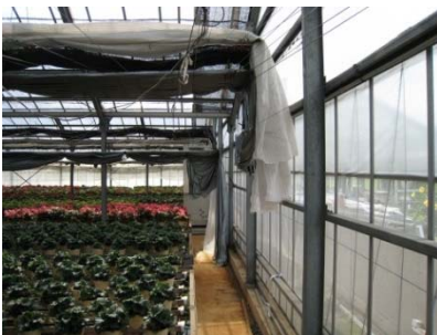
妻面のカーテンの隙間
