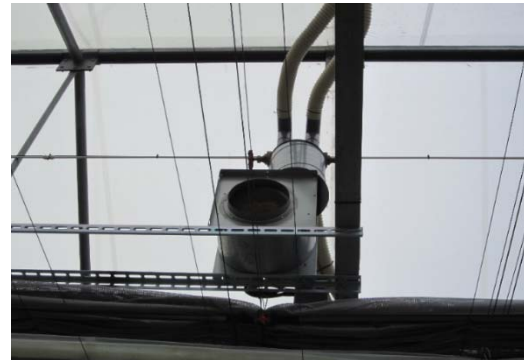
空気膜の加圧のための送風ファン
