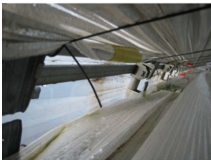
多層カーテン肩部の隙間
