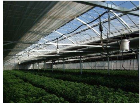
内張カーテンの自動開閉
