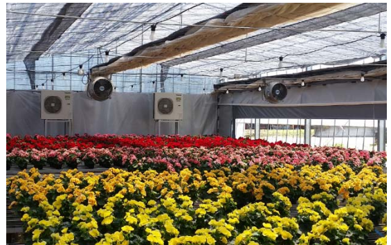
夜間冷房にも利用されるヒートポンプ
