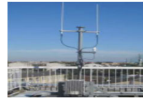
通信施設の整備
