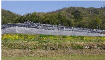
防鳥防虫ネットのある発電設備
