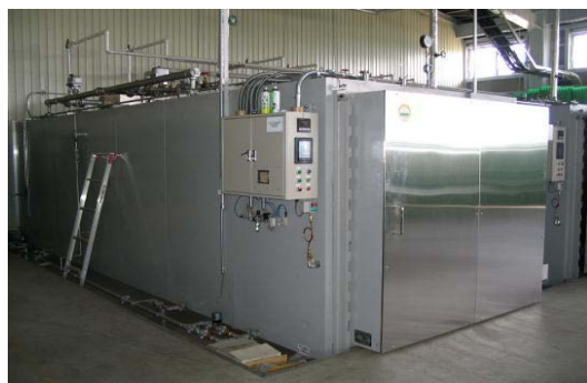
培地を殺菌する高圧釜は、3機設置されている1台当たり2,240袋処理出来る。事務室内のパソコンと接続されている。
