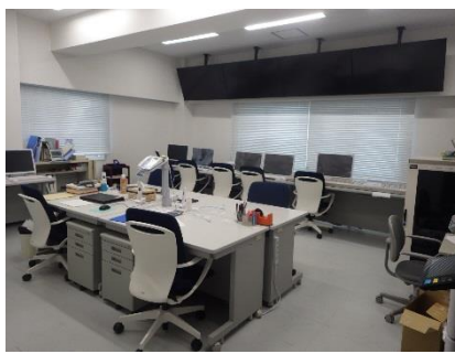
笹ヶ峰ダム管理設備（更新後）
