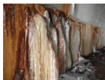
凍結、凍上圧による コンクリートの欠落
