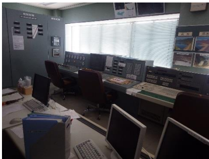
笹ヶ峰ダム管理設備（更新前）
