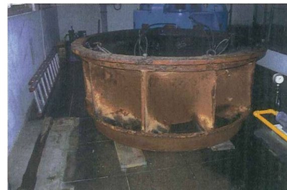
ポンプケーシング腐食状況
