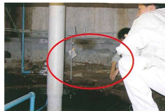
ポンプ室内・鉄筋腐食状況
