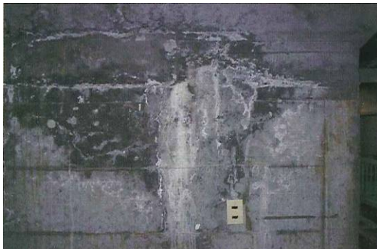
ポンプ室隔壁部劣化状況
