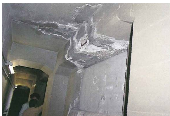
ポンプ室地下・コンクリート剥離状況
