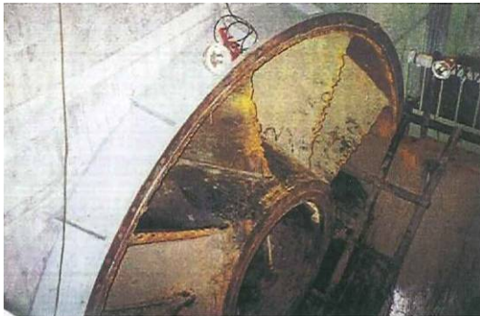
ガイドケーシング腐食状況
