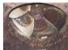
すいた 水田揚水機場 ポンプの老朽化
