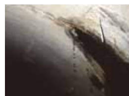
新江導水路（坂井北部地区）のトンネル部の漏水
