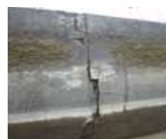
左岸中央幹線用水路 水路目地からの漏水
