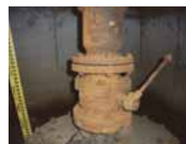
中央幹線用水路4号（坂井北部地区）の空気弁の発錆・固結
