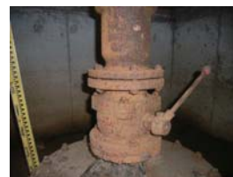
中央幹線用水路4号（坂井北部地区）の空気弁の発錆・固結
