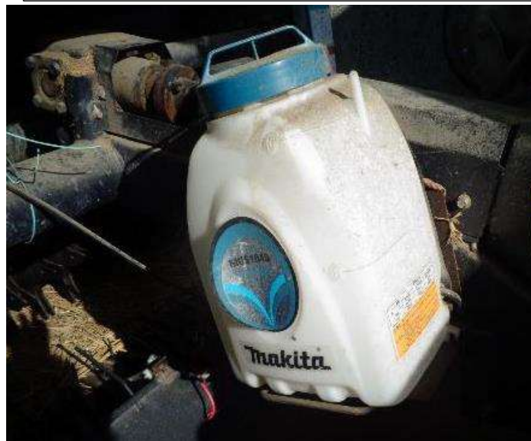
トラクターとロールベラーの連結部に乳酸菌溶液を入れるタンクを設置する置台を溶接
