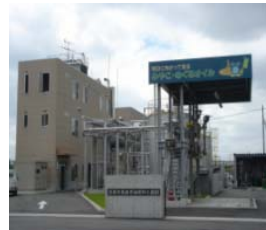
バイオディーゼル燃料製造設備
