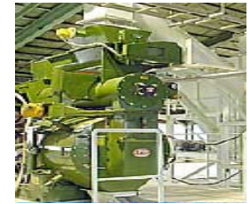
木質ペレット製造設備
