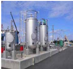
バイオエタノール製造設備
