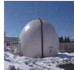
バイオガス製造設備
