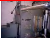
公共施設のボイラー
