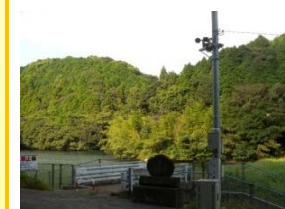
水位計や監視カメラの設置
