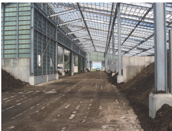
写真3 第二次堆肥処理施設 (左側が直線型攪拌発酵装置、右側が乾燥レーン)
