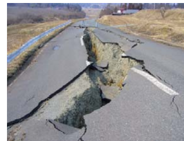
破損した農道（岩手県奥州市）
