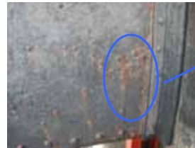
水との接触によるスキンプレート(水面側)腐食
