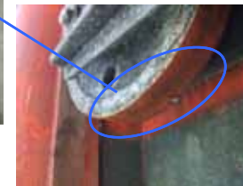
ローラ動作不良による摩耗
