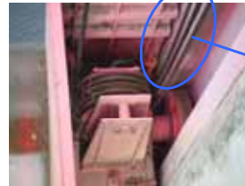
繰り返し使用によるワイヤーの素線切れ
