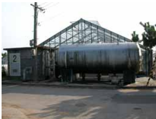
写真-6.3 老朽化の著しい現況の揚水機場及び加圧タンク
