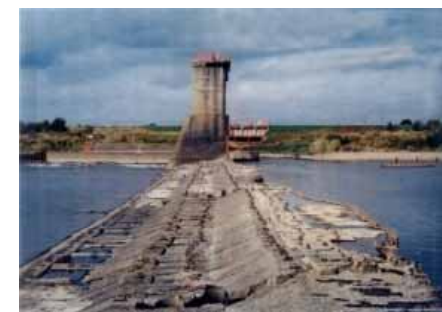
老朽化した頭首工
