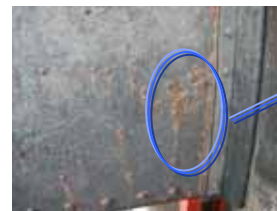
水との接触によるスキプレート(水面側)腐食
