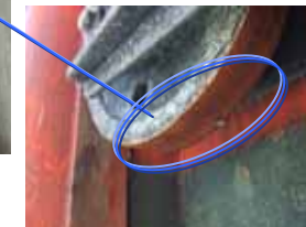
ローラ動作不良による摩耗
