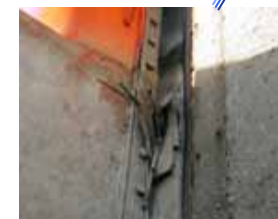
ゴミのかみ込みによる水密ゴムの損傷
