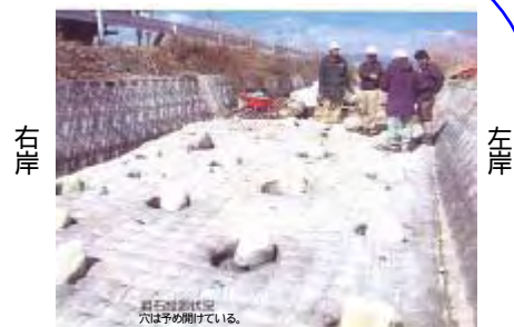
高強度布製マットにより形成された斜面に粗石を設置した状況
