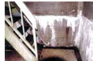
ポンプ室内コンクリート劣化
