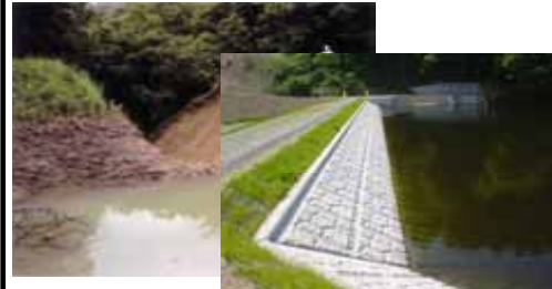
堤体の浸食と改修後のため池
