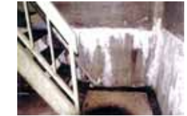
ポンプ室内コンクリート劣化
