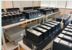
バッテリー保管・充電施設
