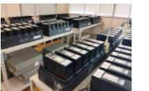
ドローンのバッテリー充電施設
