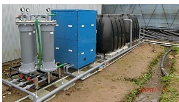
養液ろ過装置
