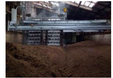
堆肥自動攪拌機
