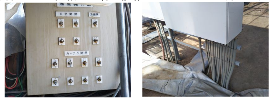
現在は古い設備で配線も複雑でメンテナンスが難しい状況
