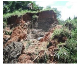
平成26年8月の豪雨により決壊したため池(京都府)
