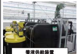
養液供給装置
