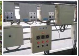
複合環境制御システム
