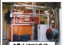
木質バイオマスボイラー
