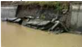
老朽化による用水路の倒壊の例
