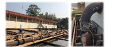
【図表17】円借款による協力の事例 <ラオス・ビエンチャン上水道拡張事業> 浄水場拡張・建設、送配水管改修・敷設等
