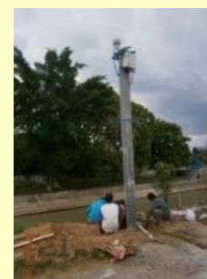
自動水位観測施設の設置
