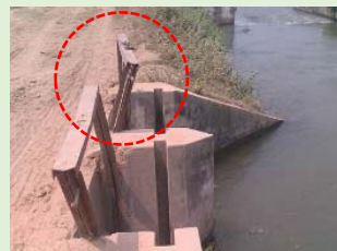
損壊した水門
