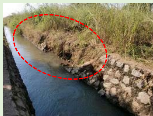
一部破損した水路
