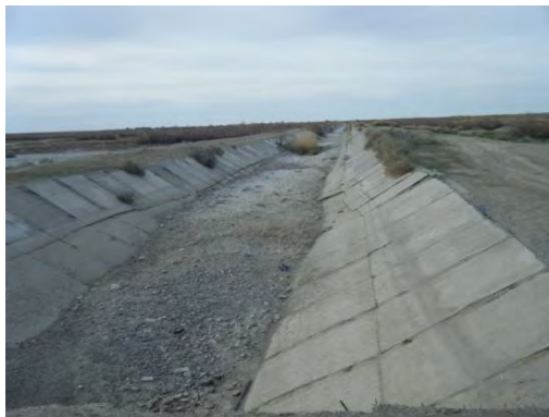
老朽化した農業用水路
