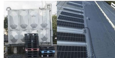
地中熱システム(左)と太陽光発電(右) を併用したクリーン工場
