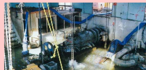
揚排水機場内が浸水し、モーターを吊り上げて排水を行った。
