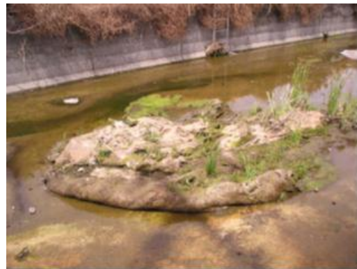
土砂の堆積状況
