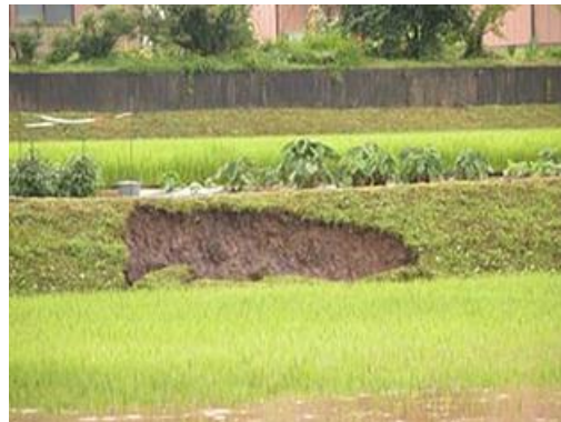
法面の崩壊状況
