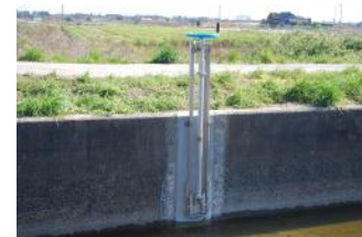
巻き上げ式ゲート（分水用ゲート）
