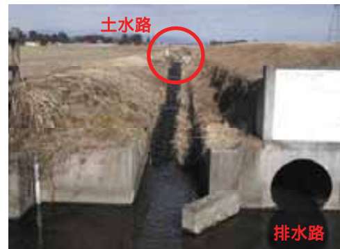
営農面で機能する排水路の上に、水生生物の生息環境として機能する土水路を配置した事例。小動物の水路への落下防止対策としても有効です。（栃木県 西鬼怒川地区）
