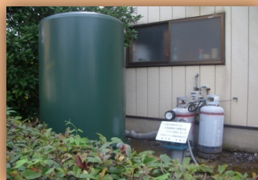
防災兼用井戸の整備
