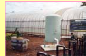
災害時にも使用可能な井戸の整備
