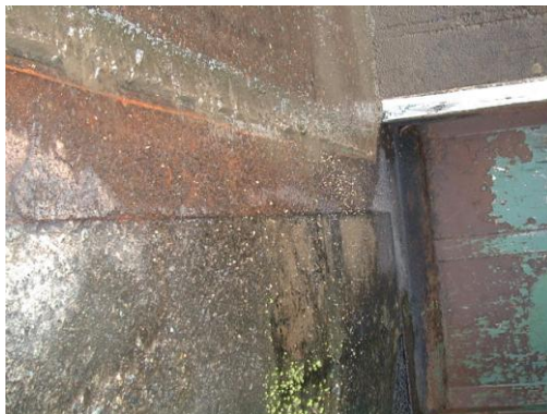
図 2.1.9 シェルゲート内部の腐食
