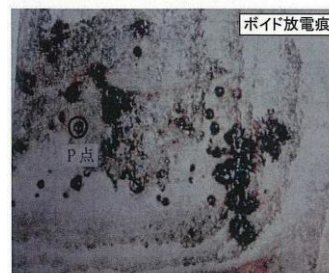
図 2.1.11 電動機固定子コイルの絶縁損耗の例
