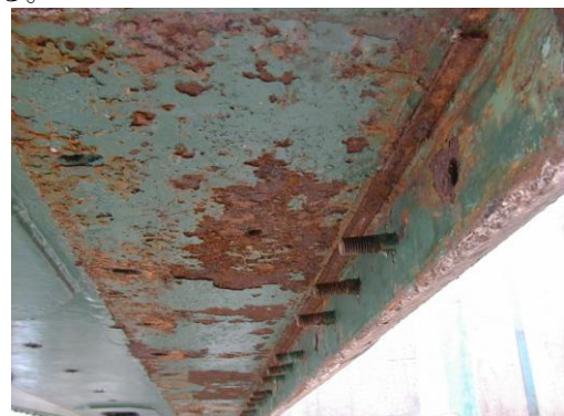
図 2.1.13 塗膜が劣化し剥離した扉体下部
