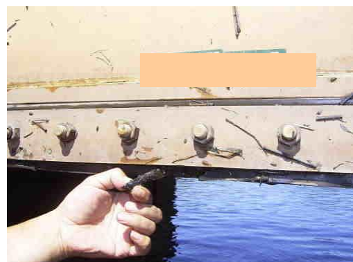
図 2.1.14 合成ゴムが劣化した事例
